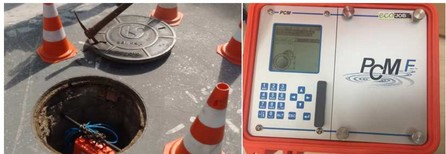
Fig.10 – Equipamento de medição de volume de esgotos
